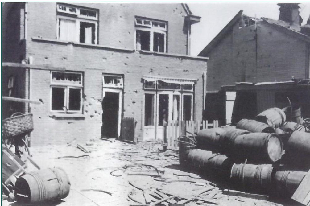
Figuur 62: Schade aan de woning van de familie Jol, Treilerweg 51. (Bron: bijlage 3, BAL, pag. 139).
