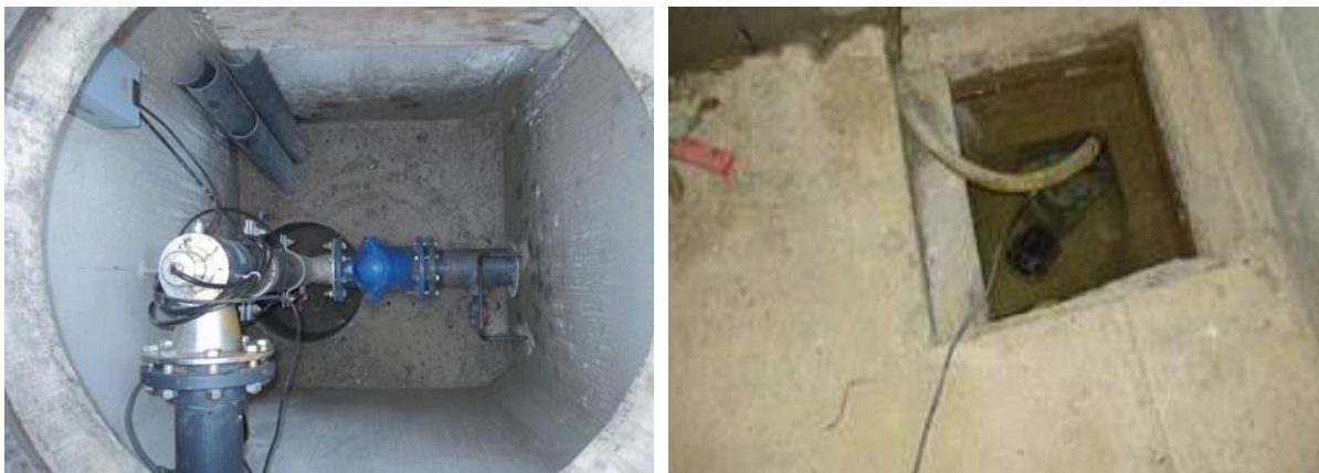
Figuur 6-3 Voorbeelden van een reservoir met een verdiepte put van waaruit het water afgevoerd kan worden naar de riolering. Foto A; Arthur Nijhof, gemeente Nijmegen
