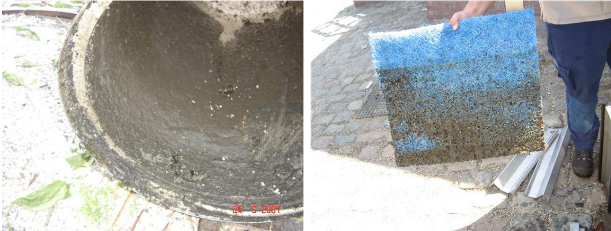
Figuur 8-2 Vervuiling van het grof filter
